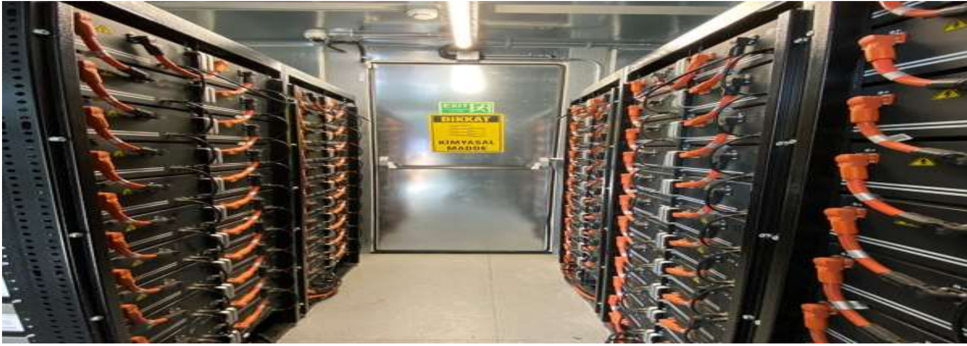
Elektrik depolayan bataryanın iç görünümü
